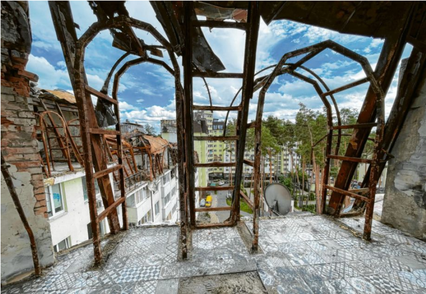
In Irpin und anderen Regionen der Ukraine haben die Kämpfe schwerste Schäden hinterlassen. Diese Wohnung büßte ganze Teile ihrer Außenwände ein. Fotos: Fridtjof Atterdal
